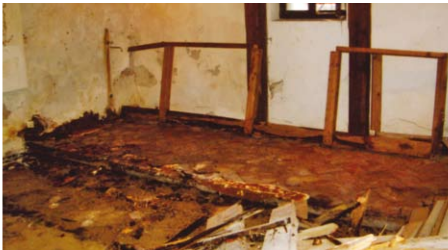
Szivárgó csapteleptől elgombásodott hajópadló. A csapteleptől 15 méterre is találtunk gombafonalakat
